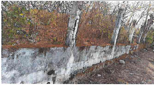
Foto 1: Situación del muro perimetral.
